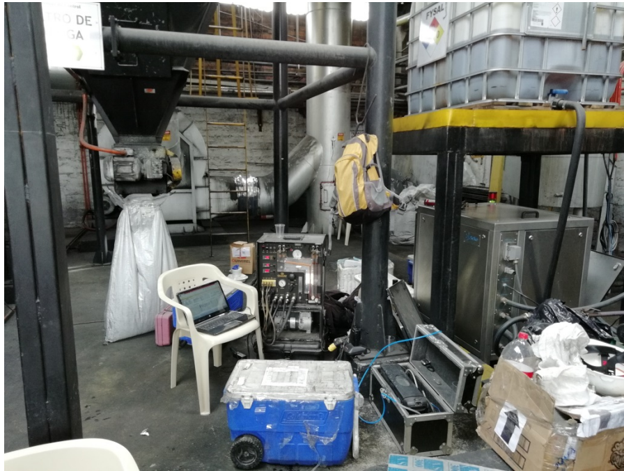
Foto 1. Vista general equipo isocinetico y Chimenea
