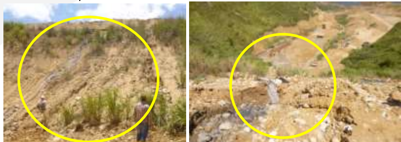
IMAGEN: Formación de surcos en el dique.
